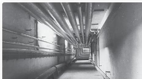
Ledningar för värme, vatten och el till alla byggnaderna inom sjukhusområdet gick i kulvertar från maskinhuset. De fungerade även som transportleder mellan vårdbyggnaderna.
